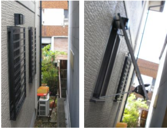
実際に壊され侵入盗の被害にあった面格子
